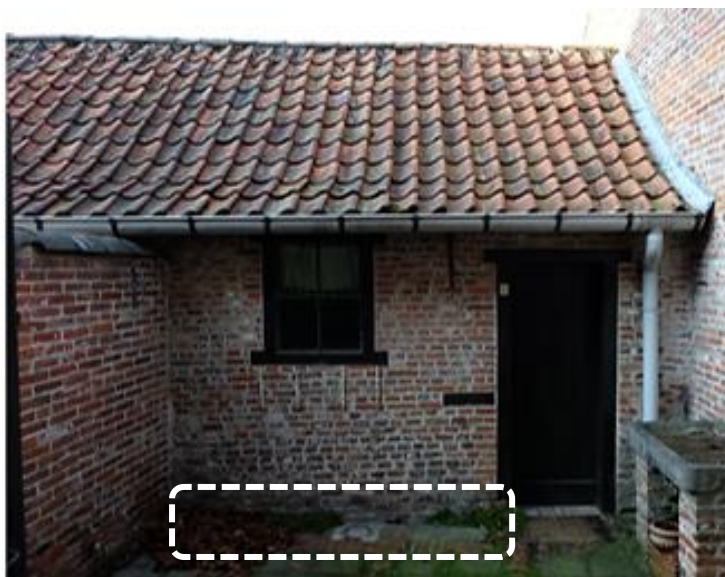
Lichte vervuiling door opspattend regenwater
