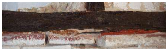
afb. 76: Roestige ijzeren liggers en afschilferende pleister- en kaleilaag.
