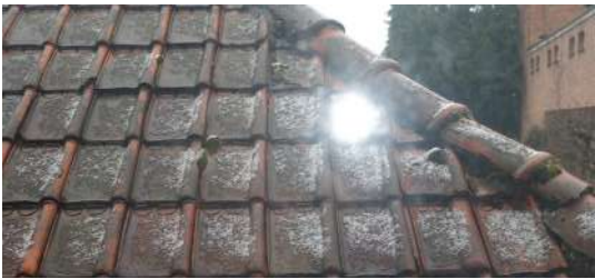
afb. 62: Uitgeschoven of gebroken (nok)pannen.
