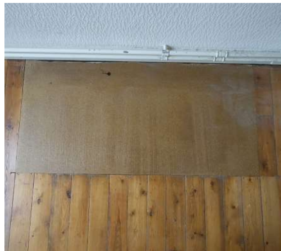
afb. 84: Uitgebroken schoorsteen, waarvan de opening is afgedekt met een plaat.
