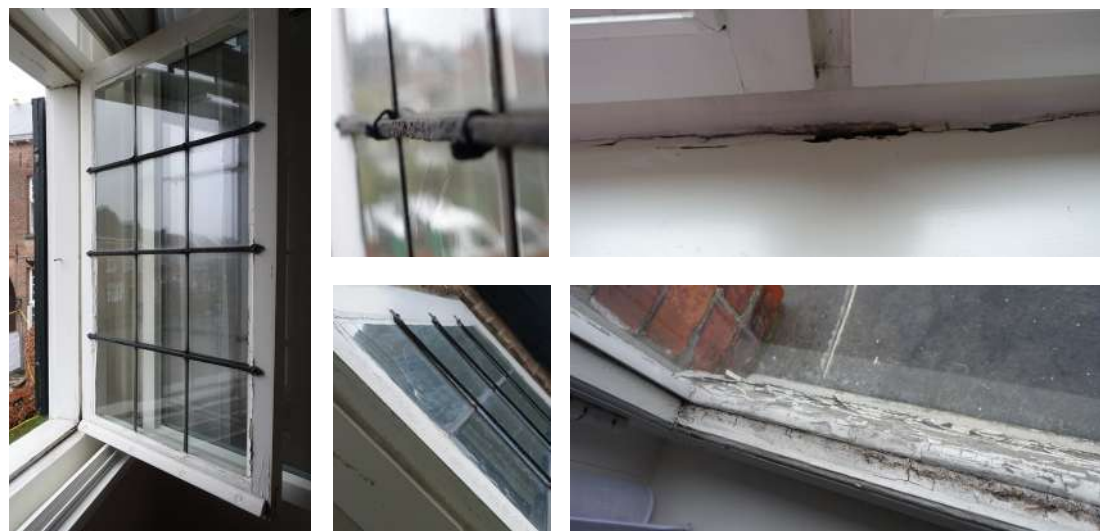
afb. 73: Plaatselijke afschilfering verflaag schrijnwerk: vensters en buitenluiken, onderaan voordeur; gebroken beglazingen.
