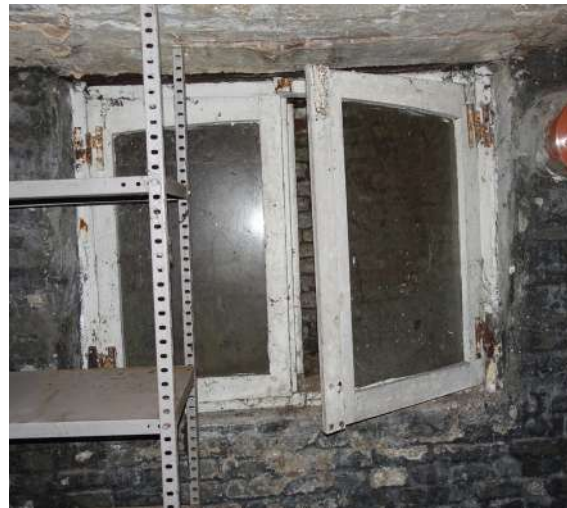
afb. 77: Keldervenster met roestig beslag.
