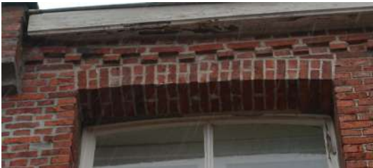
afb. 65: Plaatselijke afschilfering verflaag kroonlijst.
