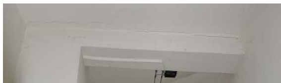
afb. 78: Scheuren in pleisterlaag plafond.
