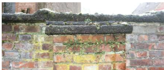
afb. 71: Gedegradeerde betonnen dekstenen.
