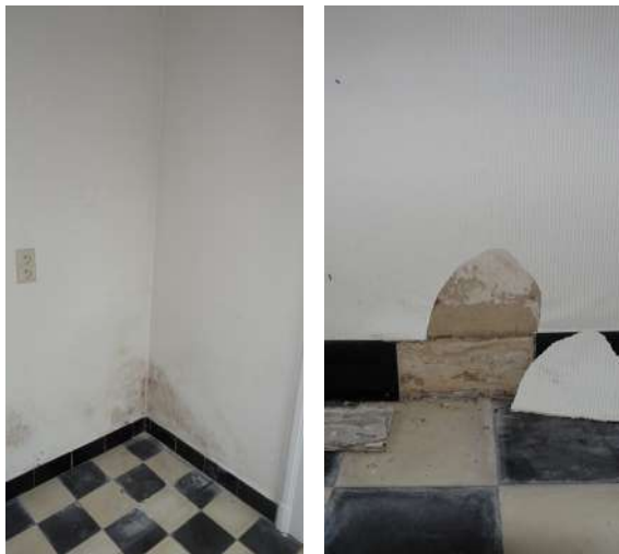
afb. 79: Vochtplekken en beschadiging plint.
