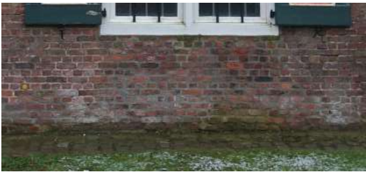
afb. 61: Plaatselijk sterk uitgespoeld voegwerk (bovenaan) en hersteld voegwerk met cementmortel.
