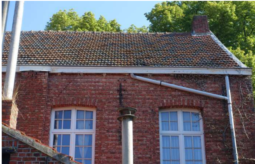
afb. 68: Scheur in bakstenen parament, uitgespoeld voegwerk (overdakse schouw), open loden slabben aan schoorsteen, verschaalde verflaag daklijst en verroest muurankers.
