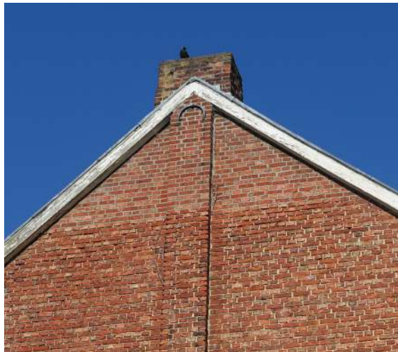
afb. 69: Uitgespoeld voegwerk, cementmortelvoegen en verschaalde verflaag daklijst (zijgevel)
