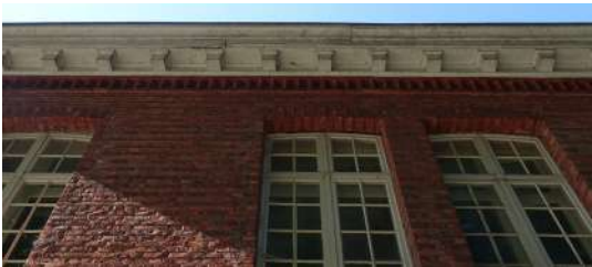
afb. 67: Plaatselijke afschilfering verflaag kroonlijst
