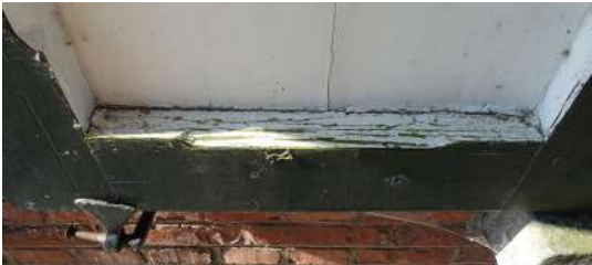
afb. 62: Plaatselijke afschilfering verflaag schrijnwerk: vensters en buitenluiken, voorgevel.
