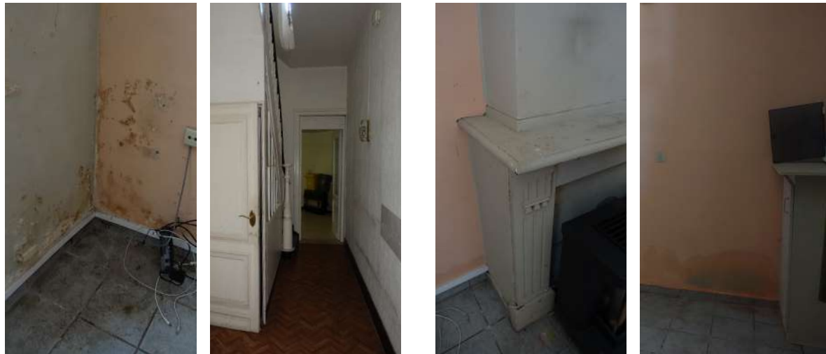
afb. 78: Vochtplekken, begane grond.
