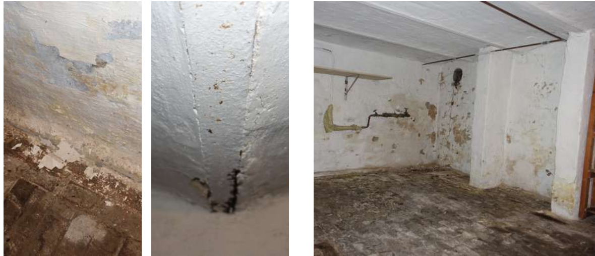
afb. 77: Kelder: vochtplekken, roestige ijzeren ligger en afschilferende pleisterlaag, huidige toestand 2024.
