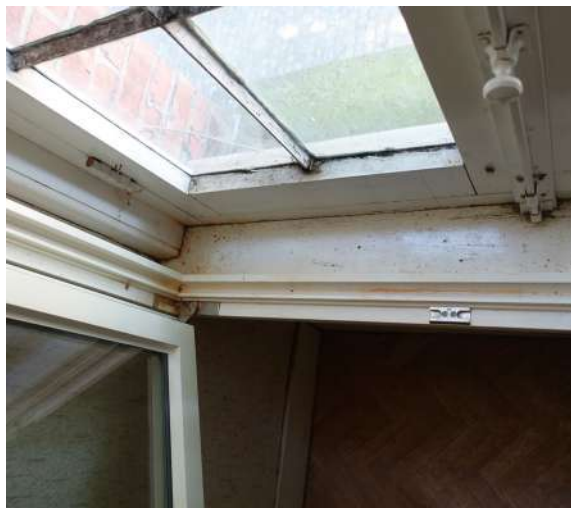
afb. 84: Gebarsten ruit (verdieping, voorgevel).
