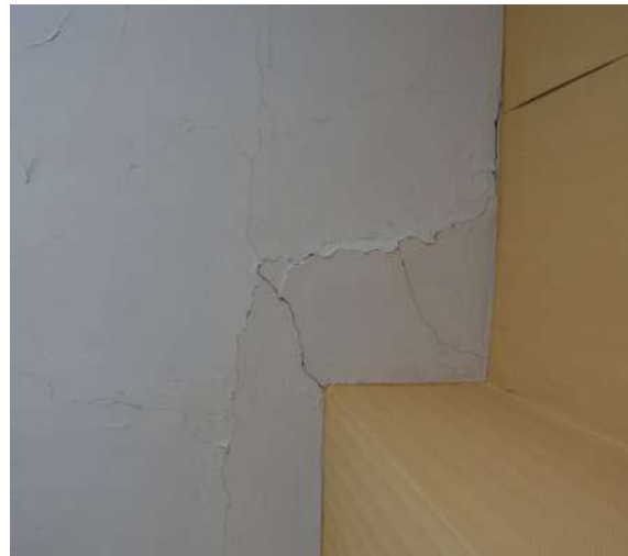
afb. 83: Scheuren in pleisterlagen (verdieping).
