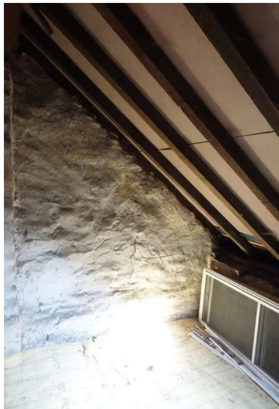
afb. 91: Barsten in pleisterlaag, scheidingsmuur (zolder).
