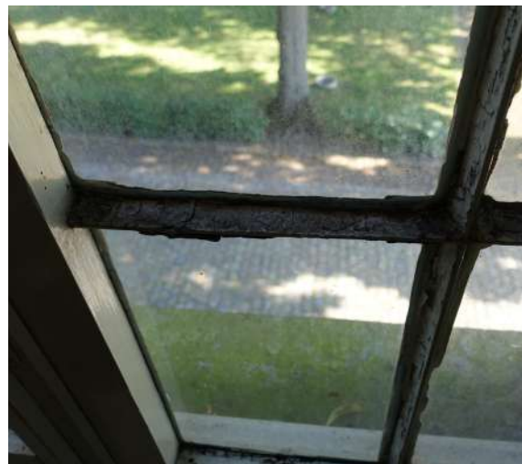
afb. 85: Afschilferende verflaag op ijzeren glasroeden (verdieping).
