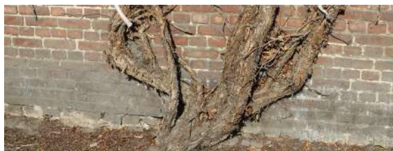
afb. 72: Uitgespoeld voegwerk aan plint (zijgevel).
