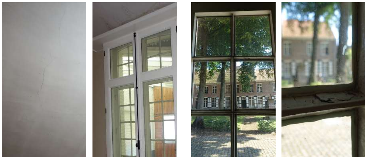
afb. 80: Scheuren en vochtplekken in pleisterlaag.
