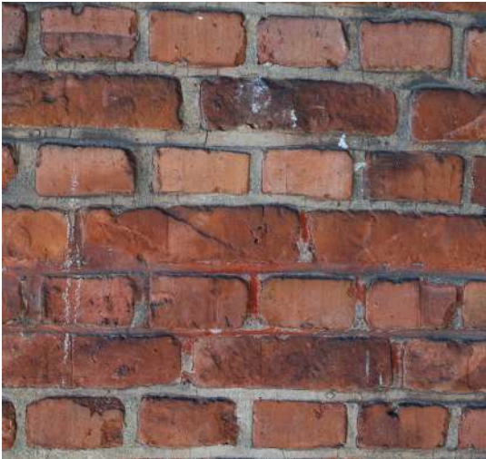
afb. 61: Gedegradeerd rood voegwerk, voorgevel.
