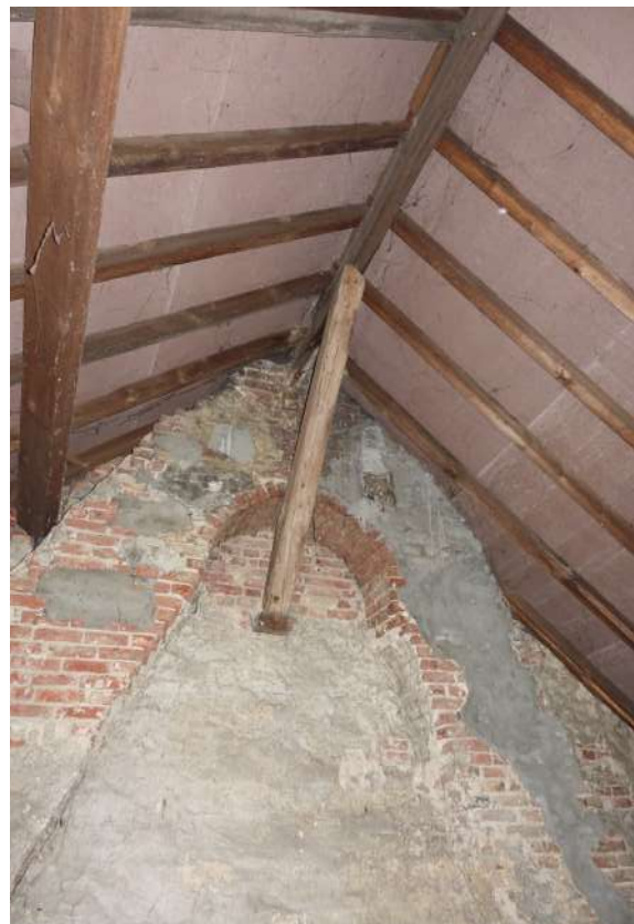
afb. 90: Beschadiging aan de wandbepleistering en cementopvullingen (zolder).
