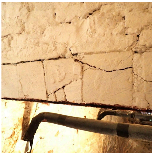
beschadigd steenwerk door sterk roestig trogprofiel
