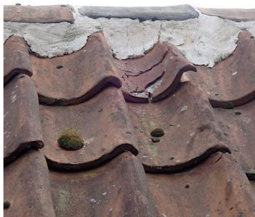
dak [2]-west: sterk verweerde pan
