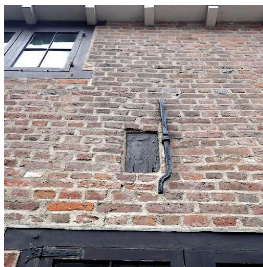
vleugel [2]-oost: scheurvorming
