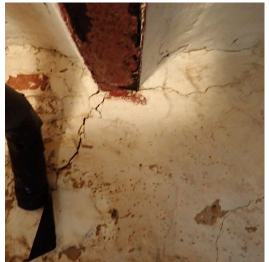
scheurvorming door sterk roestig trogprofiel
