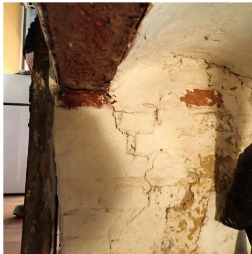
scheurvorming door sterk roestig trogprofiel
