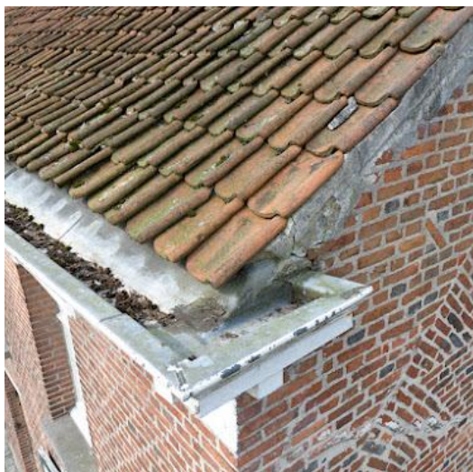
dak [1]-oost: de mortelaansluiting scheurt plaatselijk los
