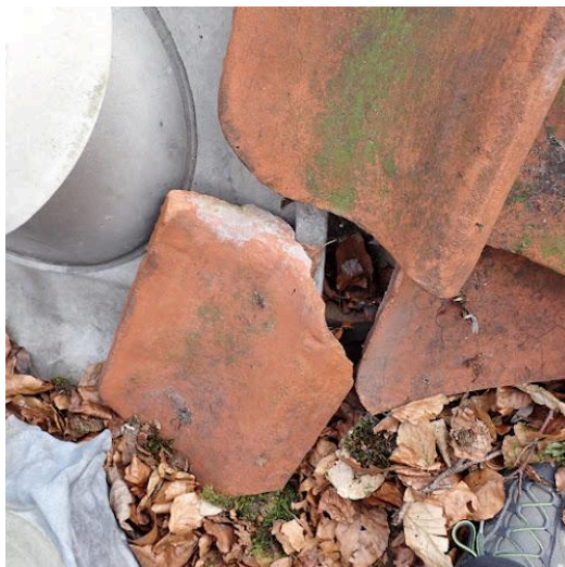
dak [2]-west: uitgeschoven pan (teruggeplaatst door Monumentenwacht)
