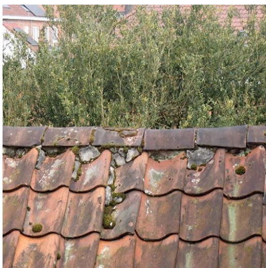
dak [3]-nokpannen: weggefallen voeg- en mortelaansluiting
