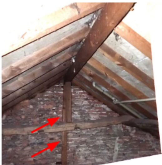
zolder [1]-west: de ondersteunende keper buigt door
