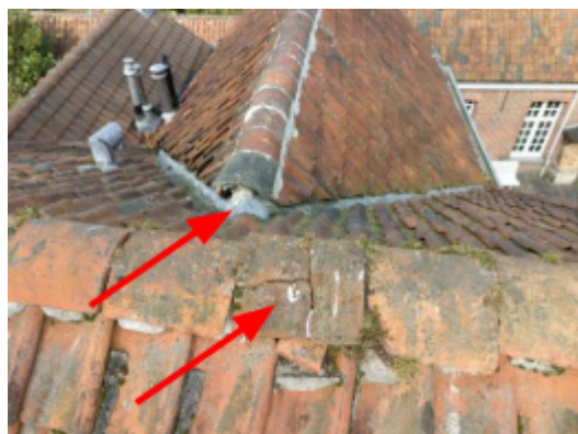
dak [1] en [2]: gebroken nokpan, wegvallende mortelaansluiting en de eind nok van dak [2] is niet afgewerkt met mortel
