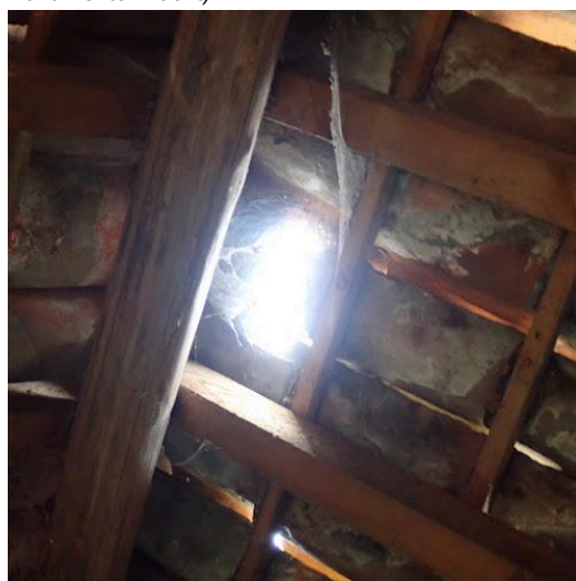
dak [3]-noord: afgebroken pan
