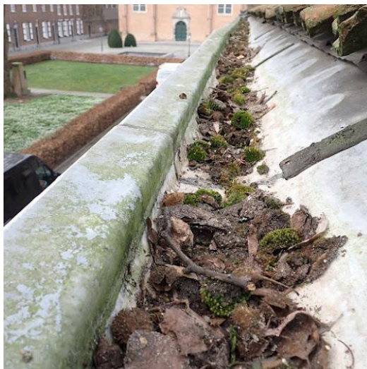
dak [1]: vervuilde goot
