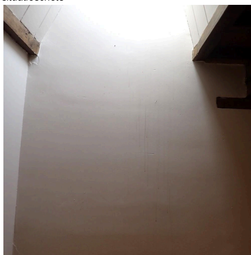
(oude) vochtsporen onder het dakvenster
