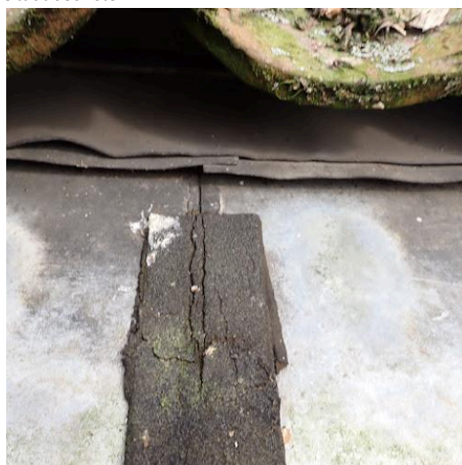
sterk verweerde roofing herstelling
