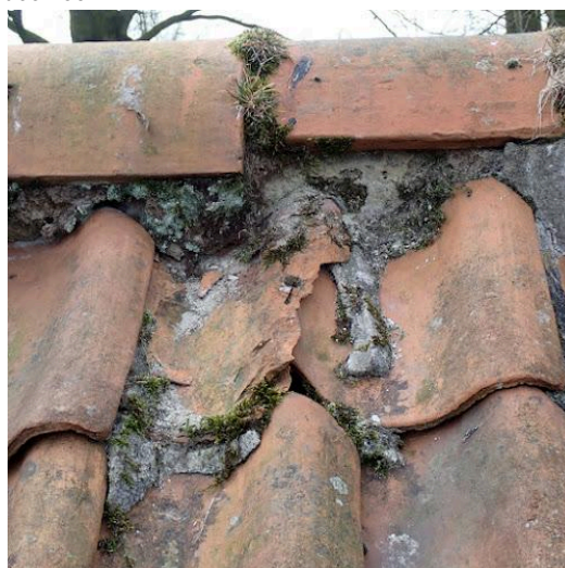
dak [1]-noord: afgebroken pan
