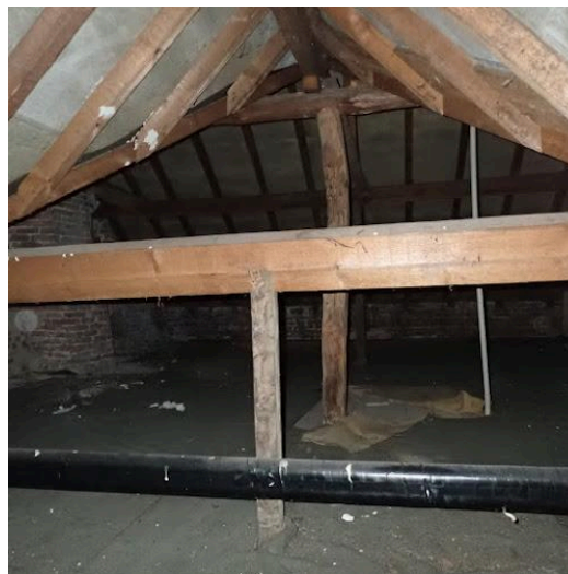
daken [1] en [2]: asbesthoudend onderdak
