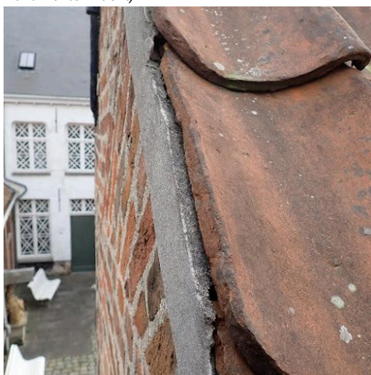
dak [2]-noord: pannen scheuren los van de mortelaansluiting
