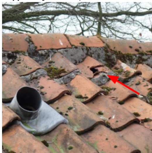
dak [1]-noord: afgebroken pan en geen regenkap op doorvoer
