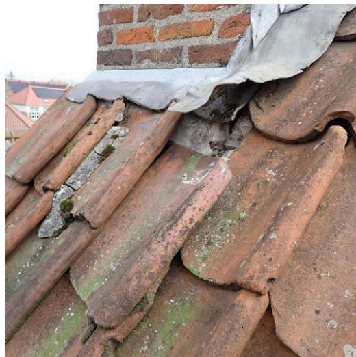
dak [2]-west: uitgeschoven pan (teruggeplaatst door Monumentenwacht)
