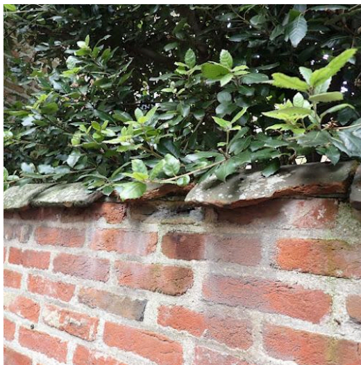
beschadigde afdekpannen en losliggende afdekpannen
