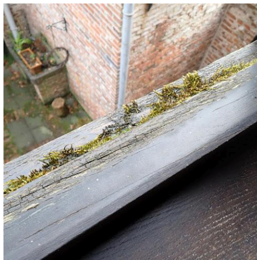
afbladderende verf met mosgroei op het blote hout
