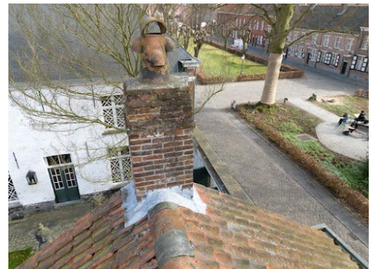
een steen is door vorst beschadigd
