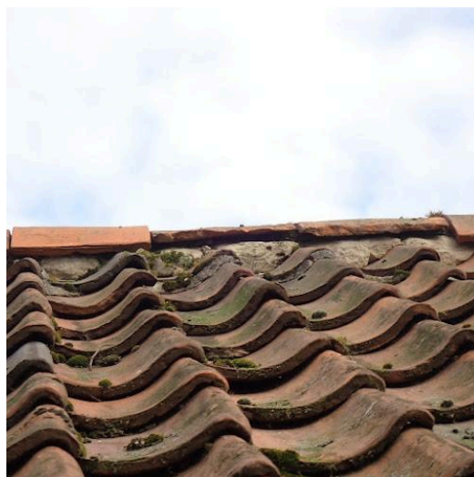
dak [1]-zuid: afgebroken nokpannen
