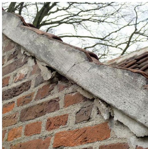
dak [1]-oost: de mortelaansluiting scheurt plaatselijk los
