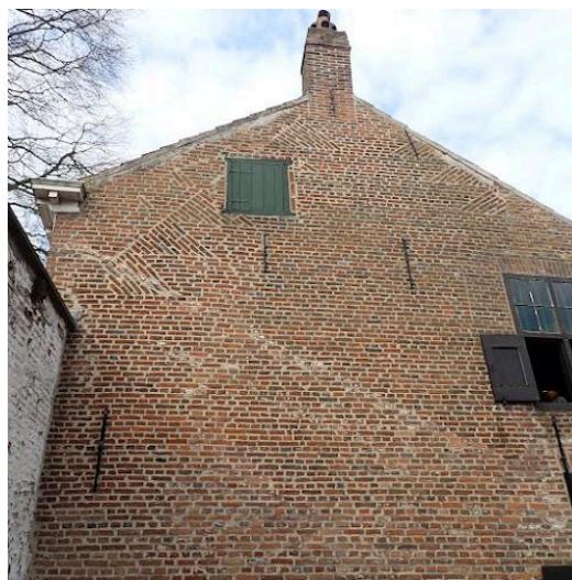
verf van enkele muurankers begint te verschromen
