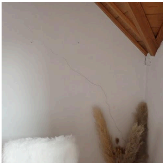
vleugel [2] eerste verdieping: scheurvorming
