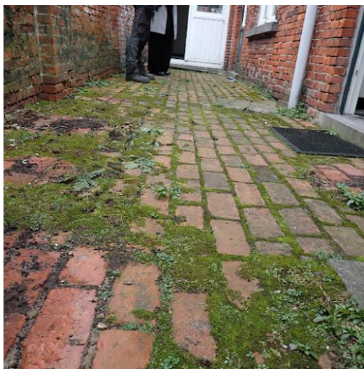
verzakkingen in het bakstenen pad
