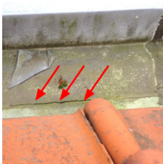
dak [1]-zuid: goot doorgescheurd
