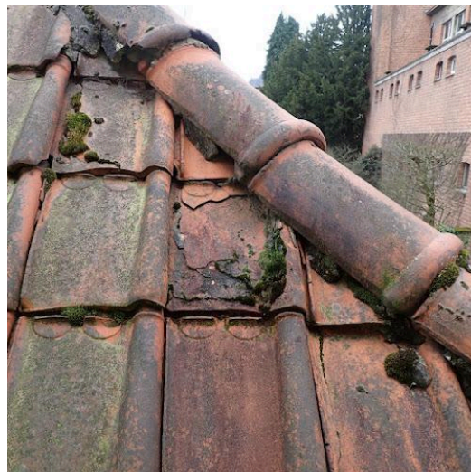
afschilferende pan en weggefallen mortelaansluiting
