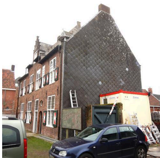
vezelcementleien mogelijk asbesthoudend
