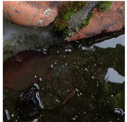
dak [2]: er blijft water en vuil in de goot staan
