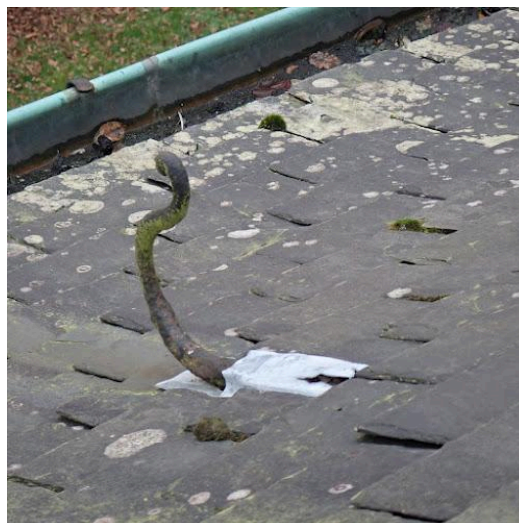
huidige ladderhaken voldoen niet aan de EN517 en mogen niet gebruikt worden
