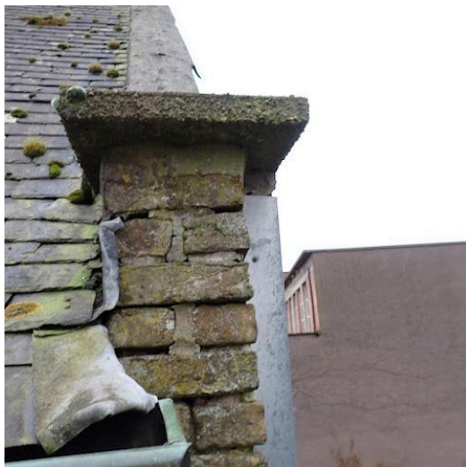
vleugel [1]: uitgespoeld voegwerk
