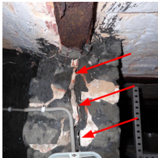
steenschade door sterke roestvorming
