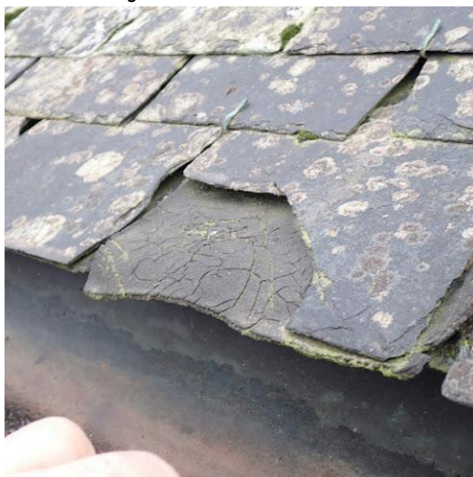
slordige herstelling met roofing
