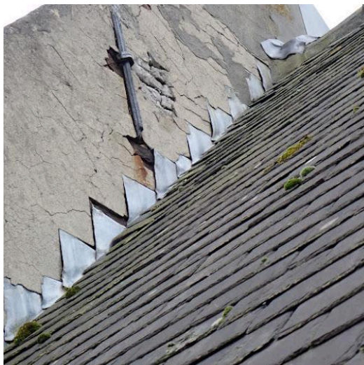
muuraansluitingen en mortels komen los
