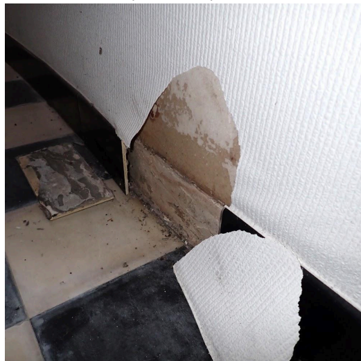
in de living weggefallen plint en holklinkende pleister door optrekkend vocht
