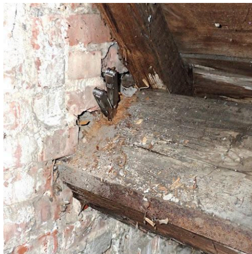
sterk ingerotte oplegging van een gording
