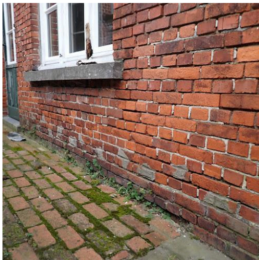
vleugel [2]: uitgespoeld voegwerk
