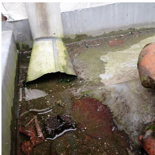
dak [1]-zuid: sterk verweerde en platgedrukte afvoer
