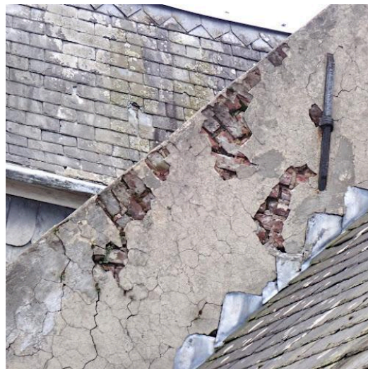
vleugel [1]: uitgespoeld voegwerk achter de weggevallen pleister
