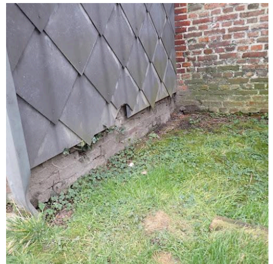
leien komen niet tot aan het maaiveld en zijn beschadigd
