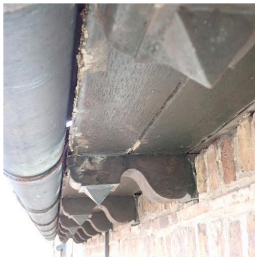
vochtschade aan de houten dakoversteek
