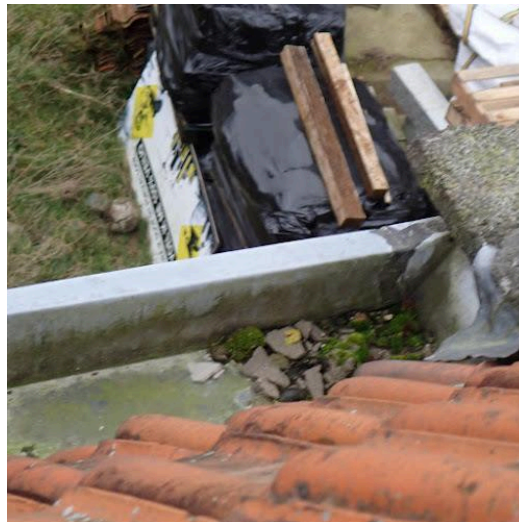
dak [1]-zuid: mortelresten in de goot
