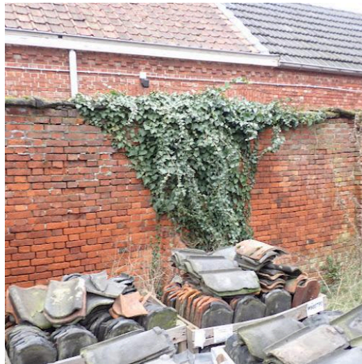
de klimop kan de tuinmuur bijkomend beschadigen
