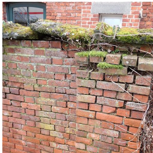
losliggende deksteen, weggevalen stenen en uitgespoelde voegen
