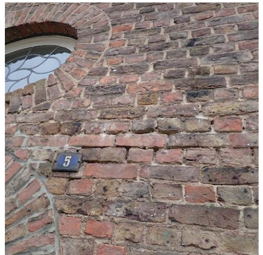
vleugel [1]: uitgespoeld voegwerk
