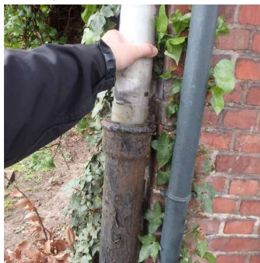
straatzijde: standpijp en afvoer staan los
