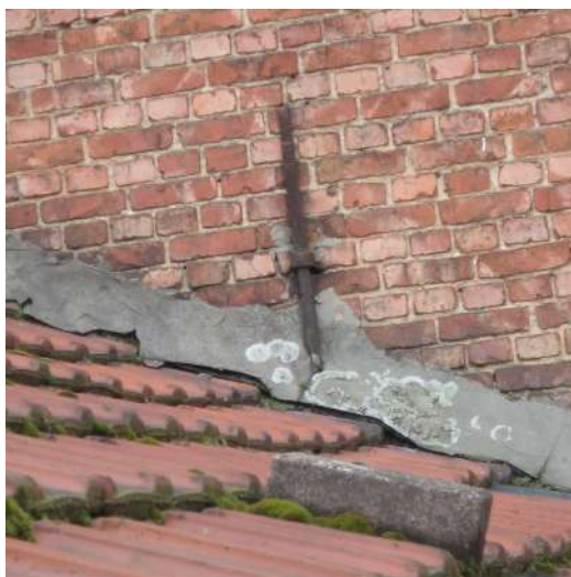
dak [2]: losgescheurde mortelaansluiting
