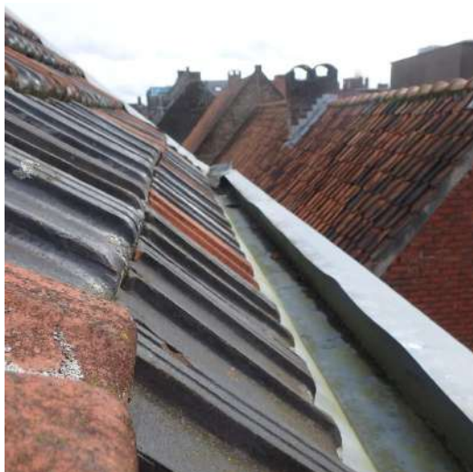
dak [1]-tuinzijde: onderste rij ligt geknikt
