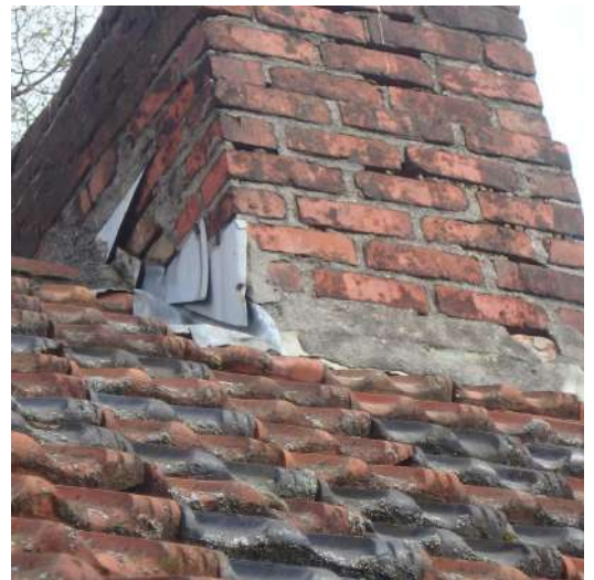
dak [1]: weggefallen zink loketten en ingescheurde mortelaansluiting
