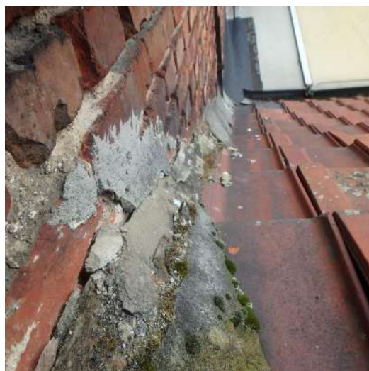
dak [2]: weggevallen mortelaansluiting
