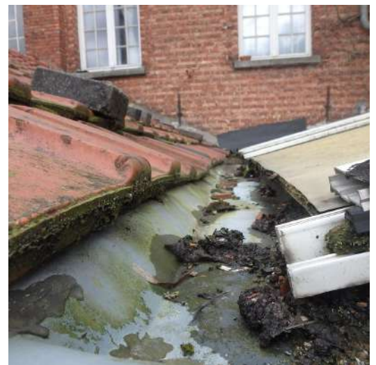
sterk verweerd zink en muuraansluiting met roofingslab uitgevoerd
