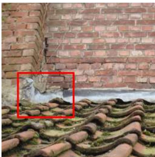
dak [5]: slordig geplaatste loodaansluiting
