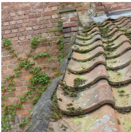
dak [5]: de mortelaansluiting scheurt los
