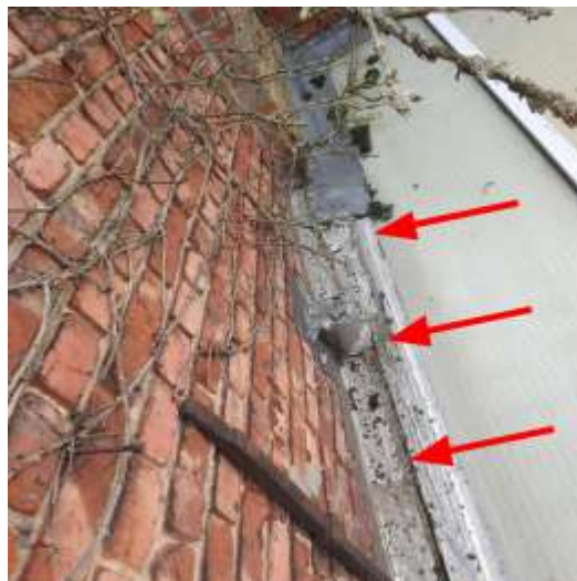
slordige muuraansluiting met bitumen tape
