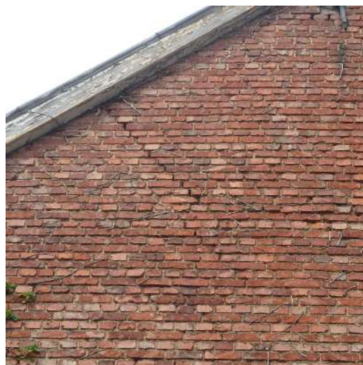
vleugel [1]-oost: scheurvorming
