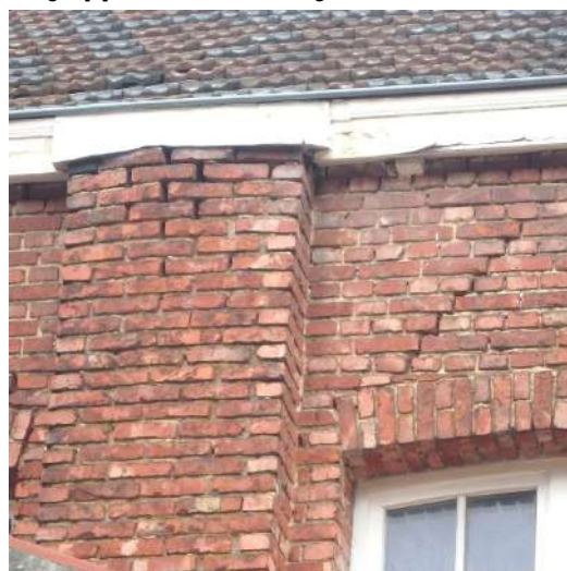
vleugel [1]-tuinzijde: weggedrukte en losliggende stenen en uitgespoeld voegwerk
