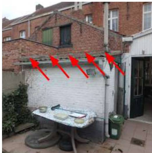
mortelaansluiting begint te scheuren
