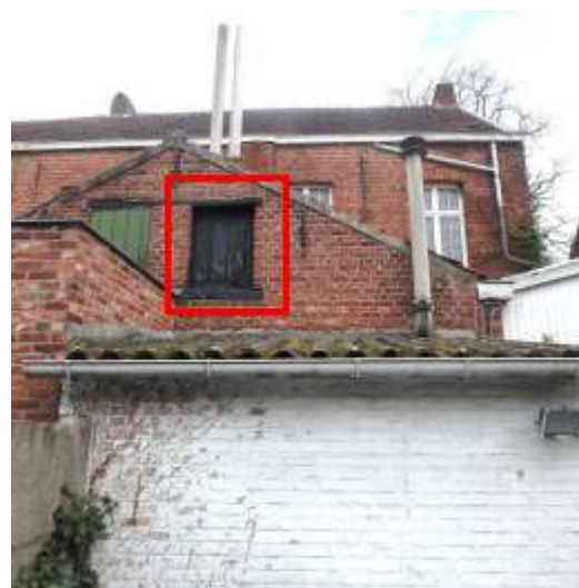
toegangsluik niet veilig bereikbaar
