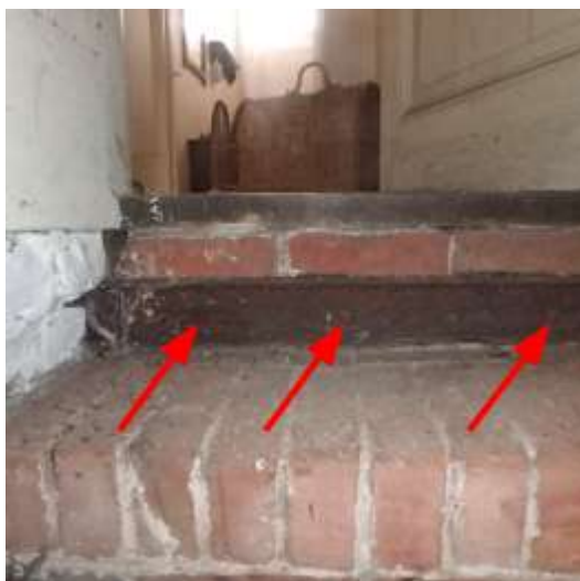
roestig profiel onder de inkomdeur
