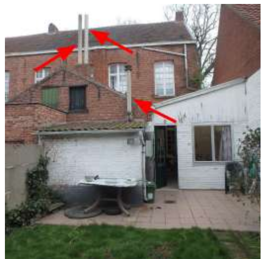
de schoorsteenpijpen zijn asbesthoudend
