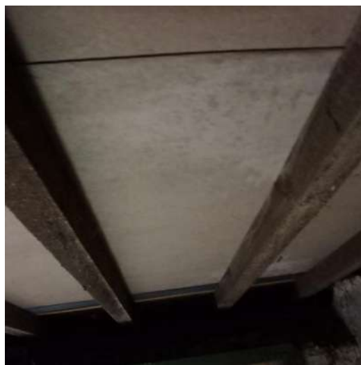
onderdak is asbesthoudend
