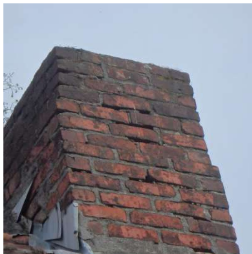
dak [1]: uitgespoelde voegen
