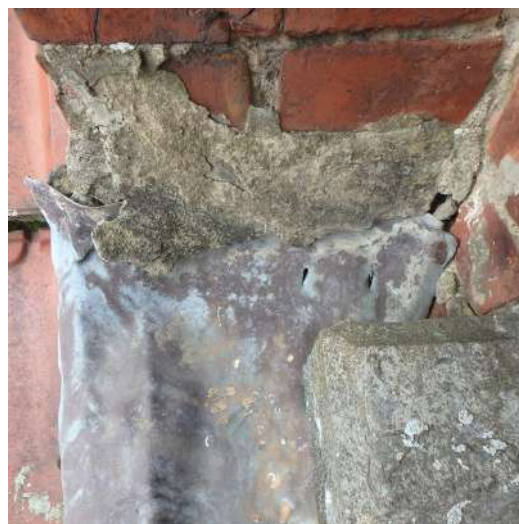
dak [2]: door verweerde loodaansluiting
