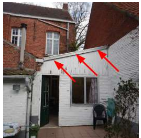
slordig afgewerkt met bitumen tape en achterstallig onderhoud van de houten afwerking
