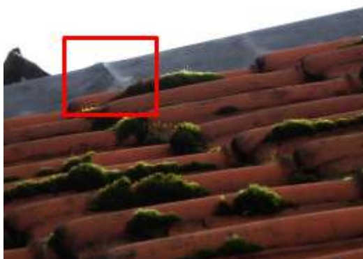
dak [1]-straatzijde: ingescheurde loodaansluiting
