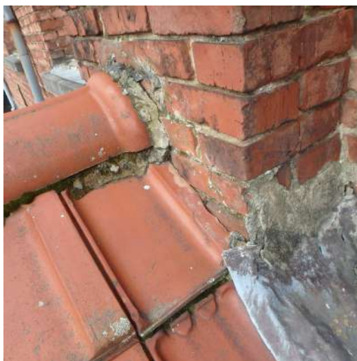
dak [2]: weggefallen mortelaansluiting
