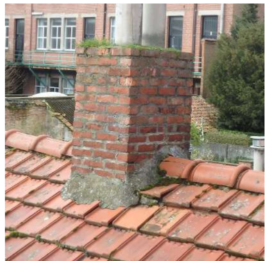
dak [2]: mortelaansluiting begint te scheuren
