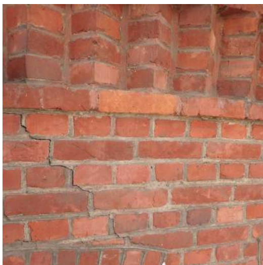
vleugel [1]-straatzijde: lichte scheurvorming
