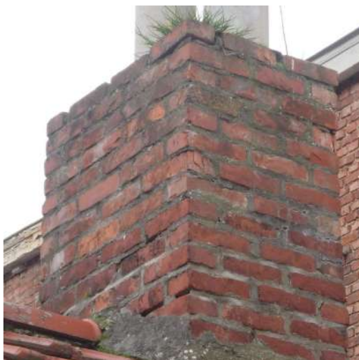
dak [2]: beperkt uitgespoelde voegen
