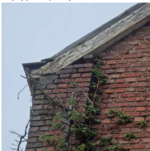
vleugel [1]-oost: weggefallen en losliggende stenen en uitgespoeld voegwerk
