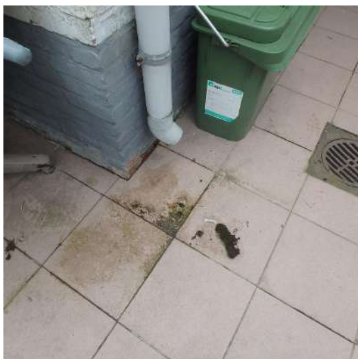
de afvoer loosd het water tegen de gevel
