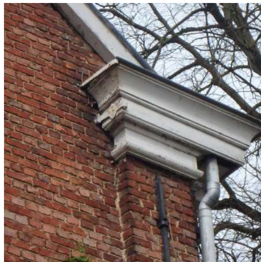
straatzijde: vochtatfekeningen en roestige verankeringen met...
