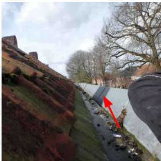
straatzijde: een soldeernaad begint in te scheuren
