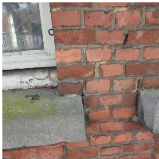
vleugel [1]-straatzijde: lichte scheurvorming
