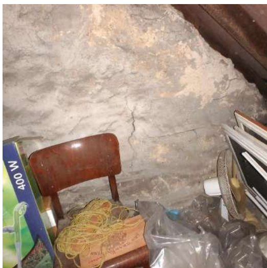
zolder [1]: lichte zettingsscheuren
