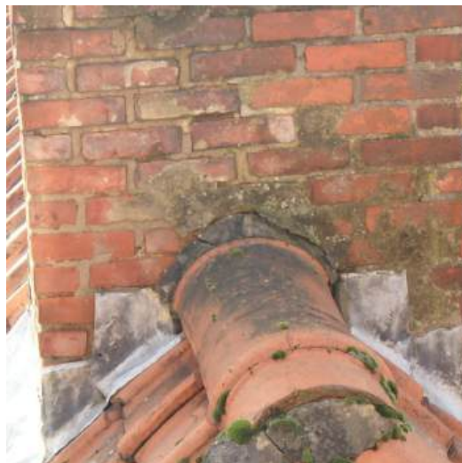
mortelaansluiting scheurt los
