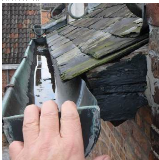
de goot helt verkeerd af waardoor er water in blijft staan
