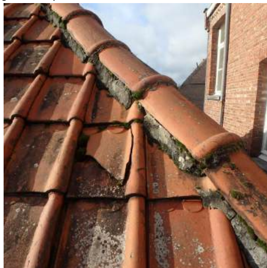
sterk schilferende pan en losgescheurde mortelaansluiting
