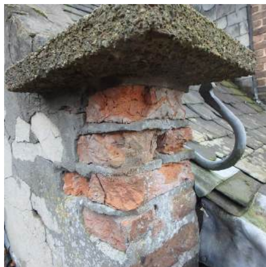
oostgevel: door vorst beschadigde stenen
