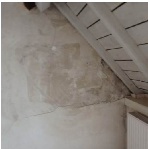
vochttaftekening en scheurvorming
