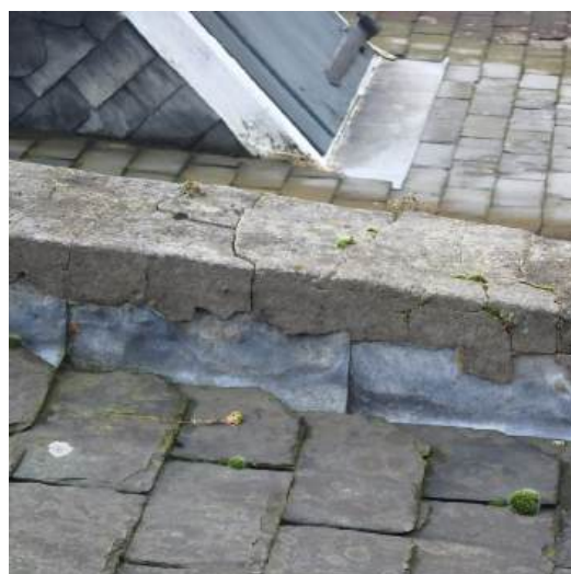
westgevel: ingescheurd pleisterwerk
