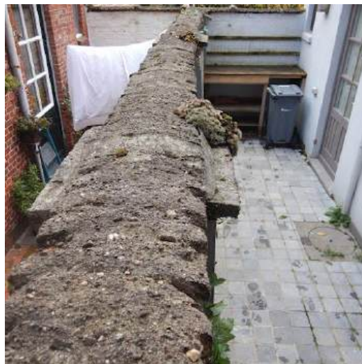
sterk verweerde en beschadigde dekstenen
