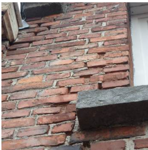
vleugel [1]-zuidzijde: het voegwerk is beperkt uitgespoeld
