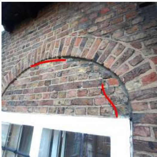
vleugel [1]-noordzijde: het voegwerk is beperkt ingescheurd
