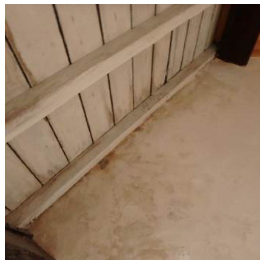
vochtaftekeningen ter hoogte van de muuraansluitingen
