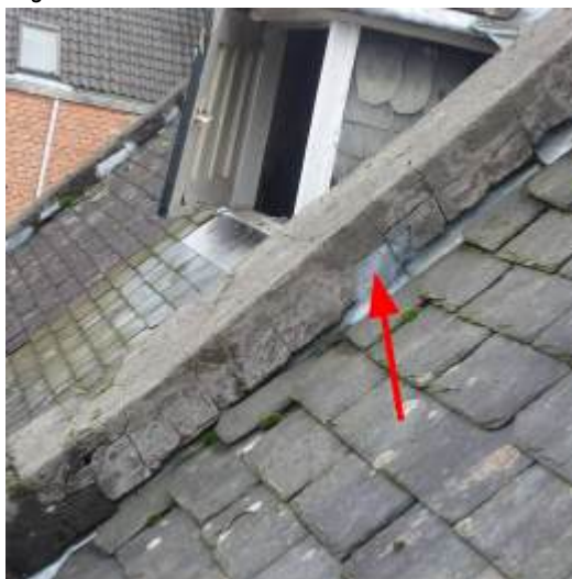
loodaansluiting is uitgezakt en mortelaansluiting valt weg
