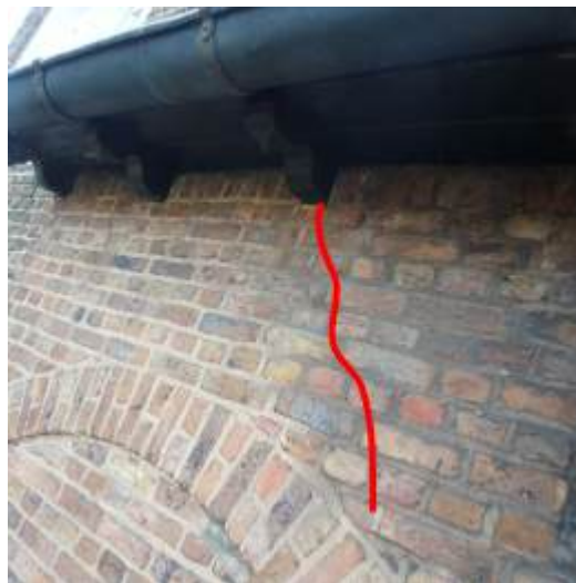
vleugel [1]-noordzijde: het voegwerk is beperkt ingescheurd
