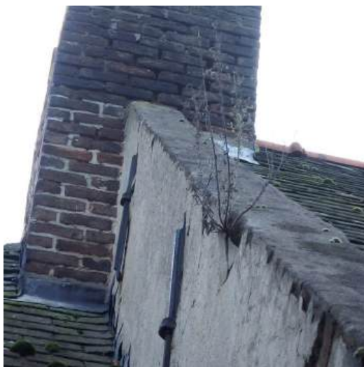
oostgevel: plantengroei in de uitgespoelde voegen
