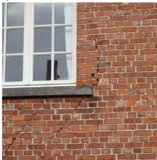
vleugel [1]-zuidzijde: structurele scheuren
