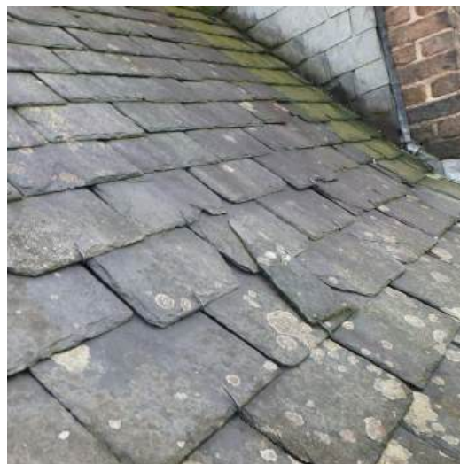
beschadigde en uitgeschoven leien
