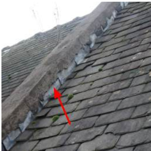
loodaansluiting is uitgezakt en mortelaansluiting valt weg
