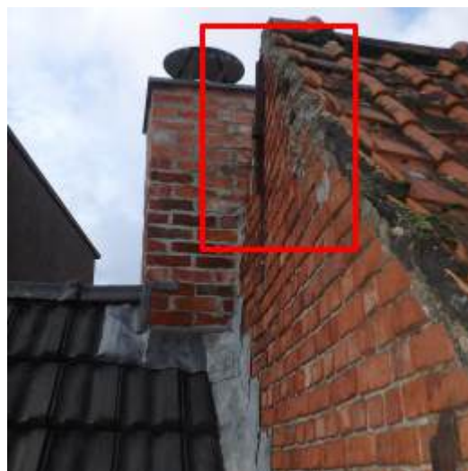
vleugel [2]-zuidzijde: uitgespoeld voegwerk
