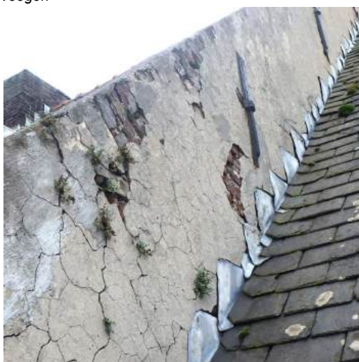
westgevel: bepleistering valt weg, uitgespoelde voegen met plantengroei
