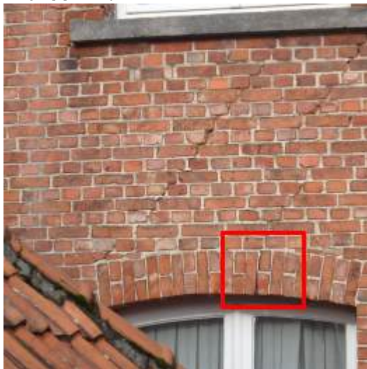
vleugel [1]-zuidzijde: een baksteen van de latei is licht verzakt
