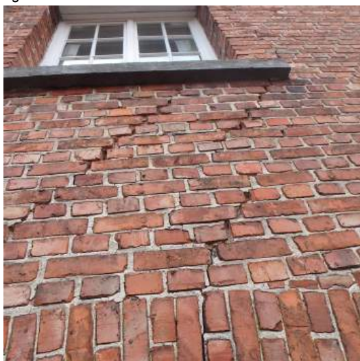
vleugel [1]-zuidzijde: structurele scheuren
