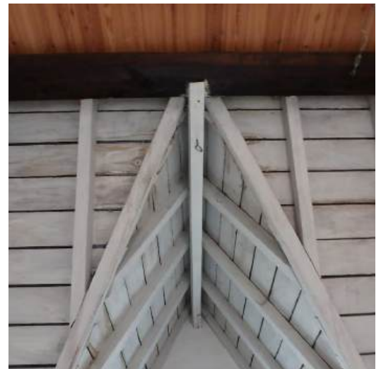
vochtaftekeningen ter hoogte van de kilgoten
