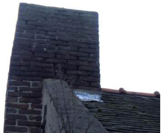
dak [1]-oost: uitgespoelde voegen
