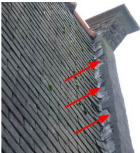
loodaansluiting is uitgezakt en mortelaansluiting valt weg
