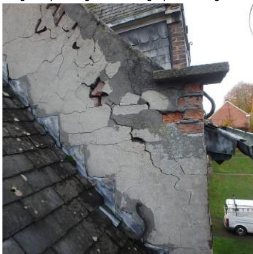
oostgevel: beschadigd pleisterwerk en uitgespoelde voegen
