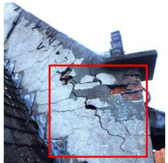
oostgevel: onder het schouderstuk is het steenwerk losgescheurd
