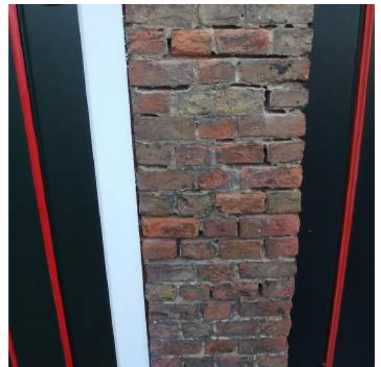
vleugel [1]-noordzijde: het voegwerk is beperkt uitgespoeld
