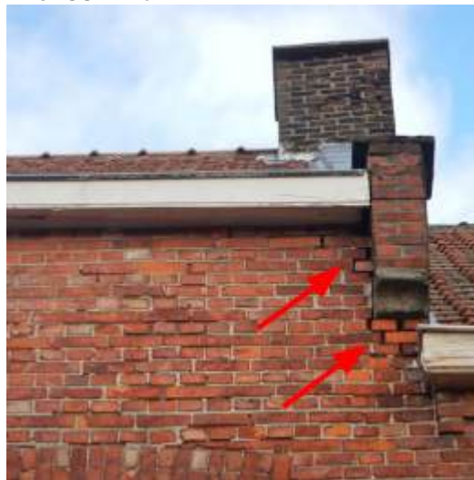
vleugel [1]-zuidzijde: het voegwerk is beperkt uitgespoeld
