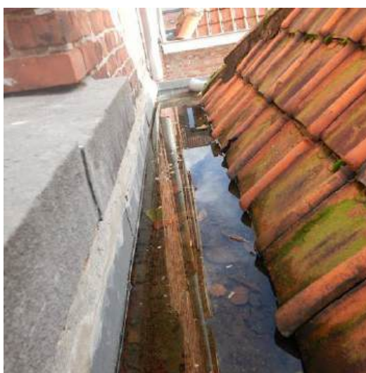
dak [2]: de goot is vervuild en er blijft water in staan
