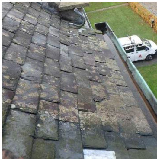
verweerde en plaatselijk gebroken leien
