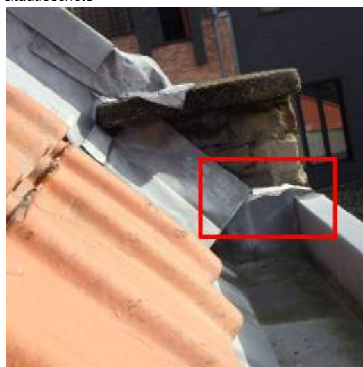
de kitafchting begint in te scheuren
