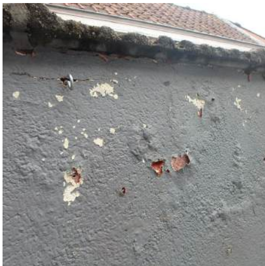
dampdichte verf bladdert af en beschadigd pleisterwerk
