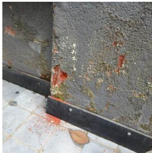
dampdichte verf bladdert af en beschadigd pleisterwerk
