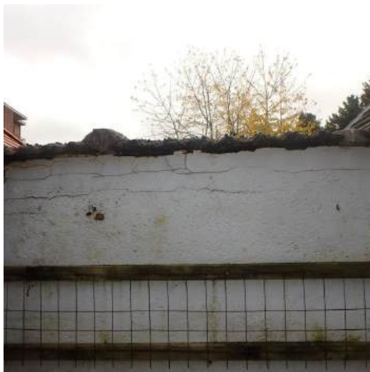
de pleister vertoont scheurvorming
