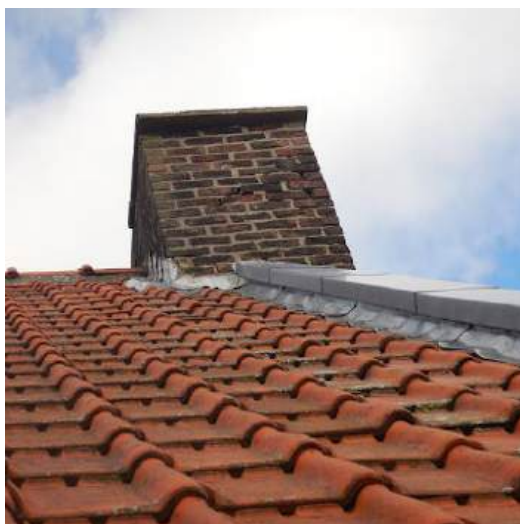
dak [1]-oost: uitgespoelde voegen
