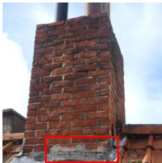
dak [2]: loodslab komt los
