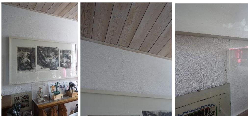
Afbeelding 64 tot 66: Scheur in de woonkamer die doorloopt over de volledige hoogte van de scheidingsmuur.
