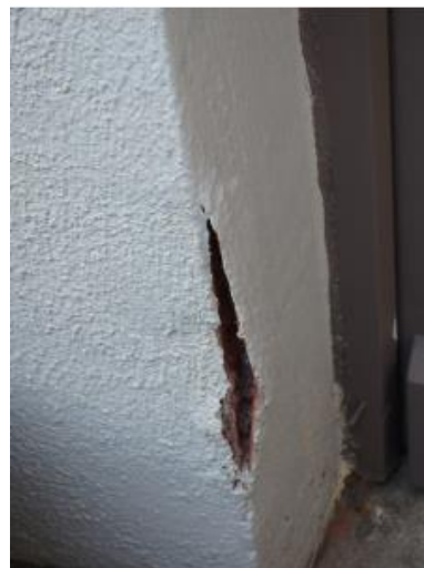
Afbeelding 61: Gebarsten pleisterwerk van de aanbouw
