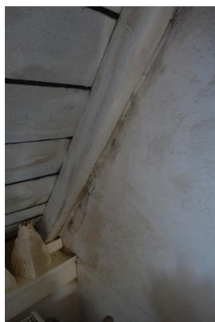
Afbeelding 75: Schimmel op de rechter scheimuur
