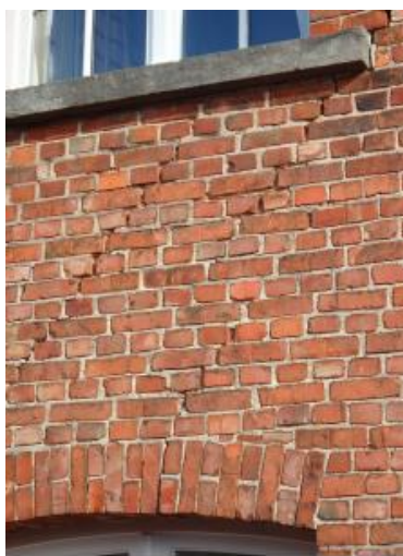
Afbeelding 59: Scheuren onder het raam
