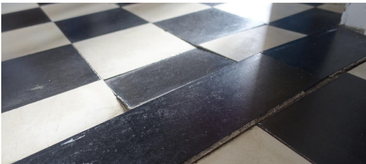
Afbeelding 71: Detail van de schade aan de vloer
