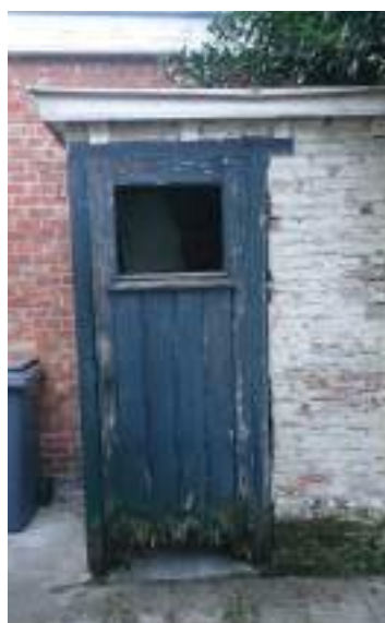
afb. 66: Beschadigde deur toiletkotje.
